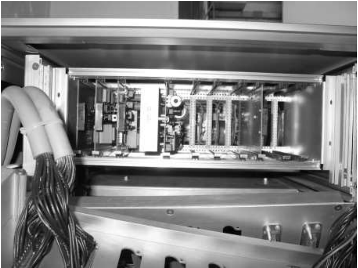
Abb.1: Die oberen Kartensteckplätze der Kontrolleinheit. Die Blenden sind bereits entfernt.
